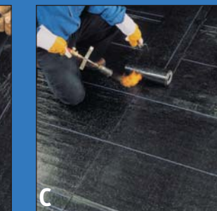
C Sceller les joints alignés en installant au chalumeau une bande de protection de 300 mm centrée sur le joint.
